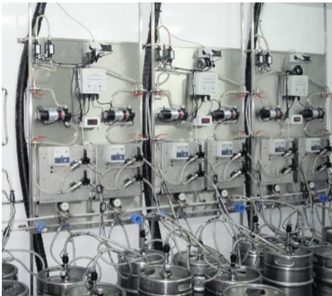
Einer von acht Kühlräumen in der Berliner O2-World: Von hier fließen Hunderte Liter Bier zu 150 Ausschankstellen in der Halle.
